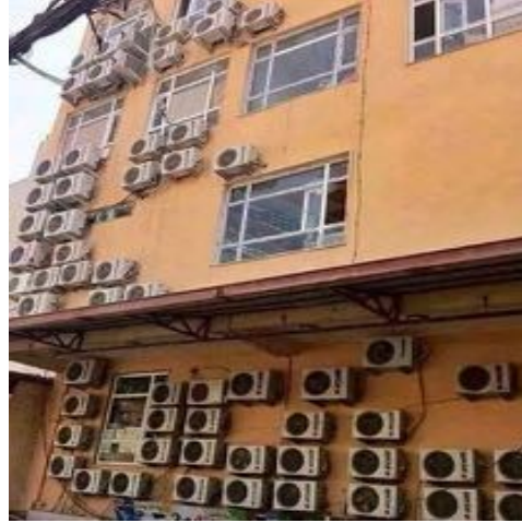
Şekil 3. Yeterli olmayan iç iklimi düzenlemek amacıyla klima takılmış dış duvar
